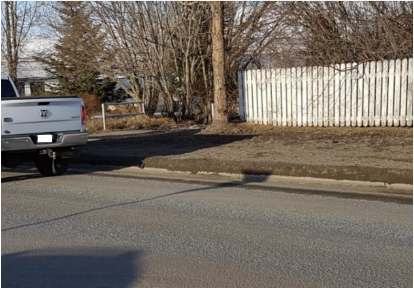
Hlíðarbraut við Teigasíðu, 10.4.2018. Drullan nær a.m.k. 20 cm upp fyrir kantsteininn.
